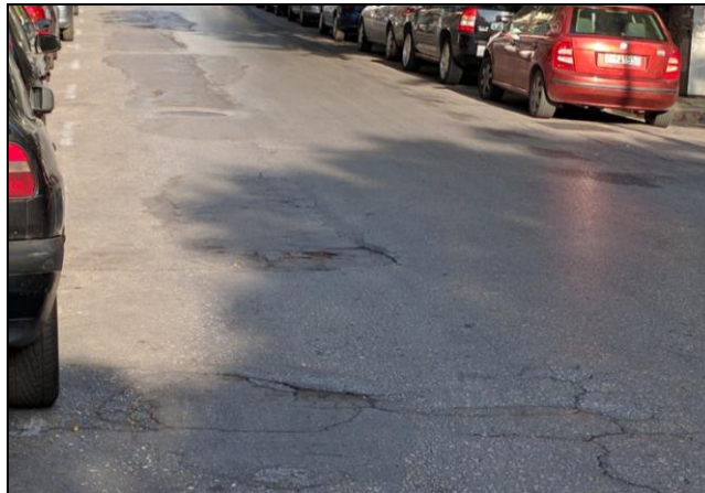
Εικόνα 15 - Φειδιππίδου (Περιοχή ανωμαλιών οδοστρώματος)
